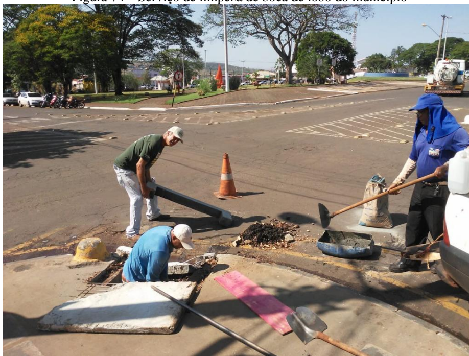
Figura 74 – Serviço de limpeza de boca de lobo do município
