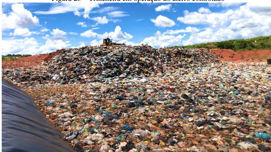
Figura 23 – Trincheira em operação do aterro controlado
