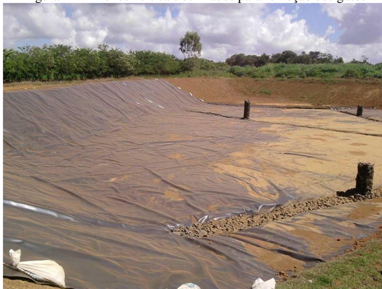
Figura 21 – Drenos verticais utilizados para remoção dos gases
