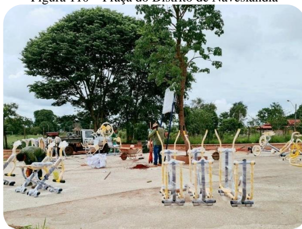
Figura 110 – Praça do Distrito de Naveslândia
