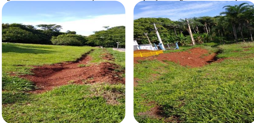
Figura 124 – Curva de contenção na área de captação de água do manancial público
